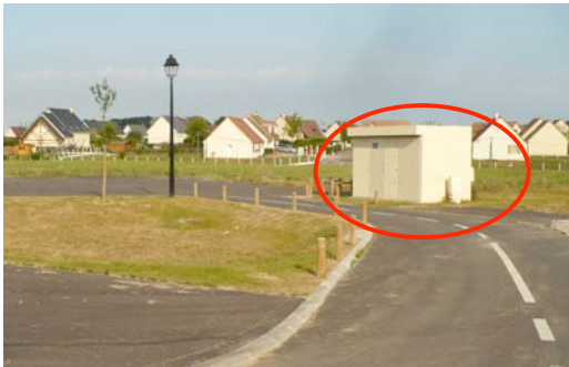
Transformateur bien visible dans l'axe de la voie.
